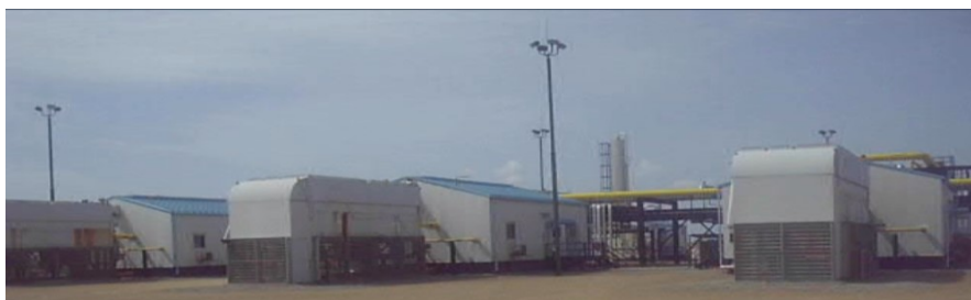
Рис-1. Газокомпрессорные агрегаты ГТЭС Кумколь
